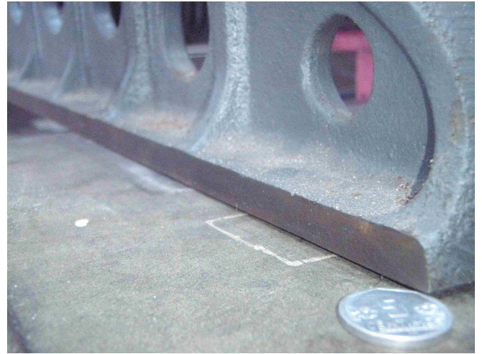
Fuente: P4272974.JPG Desnivel encontrado (sentido axial, Turbina -Generador)
